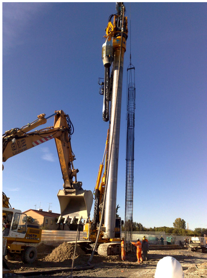
Posizionamento di una gabbia di armatura all'interno del palo in cls ad avvenuta realizzazione dello stesso
