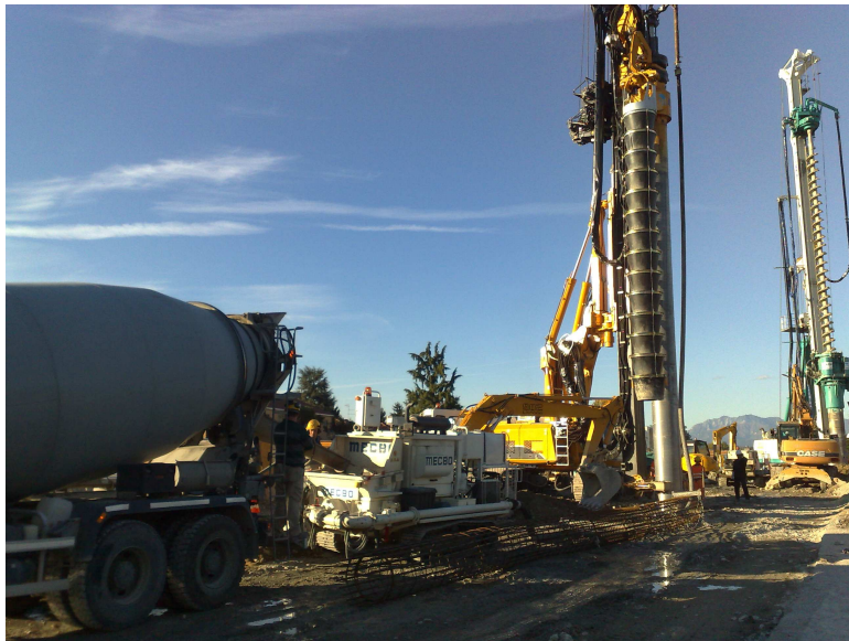
Il treno di esecuzione di un palo trivellato betoniera – macchina di pompaggio – macchina per l'esecuzione del palo
